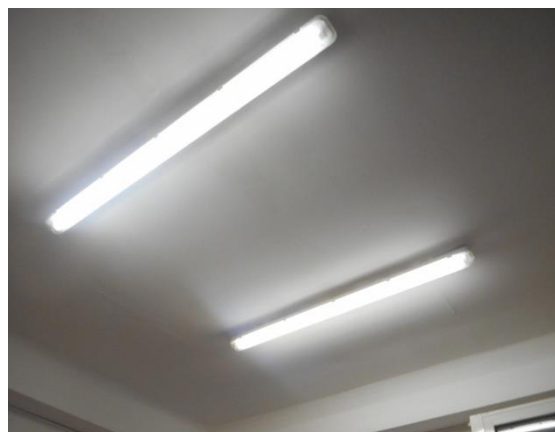
Figura 4.11 - Particolare dei corpi illuminanti
